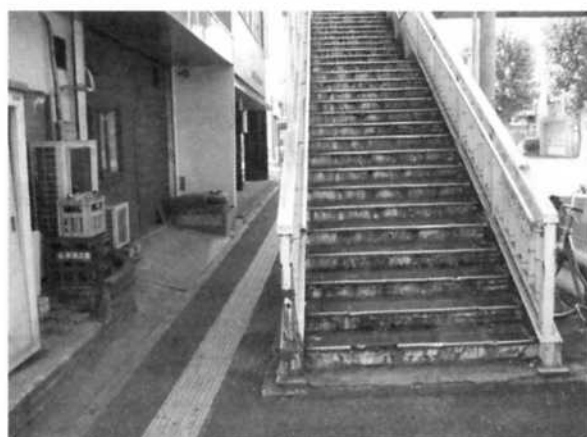
[老朽化し、歩道の4分の3を占める院内歩道橋]
